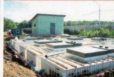
Хозяйственно-бытовые очистные сооружения
